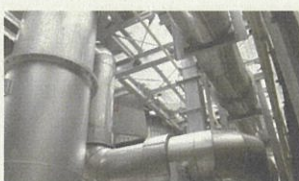
プラント配管
